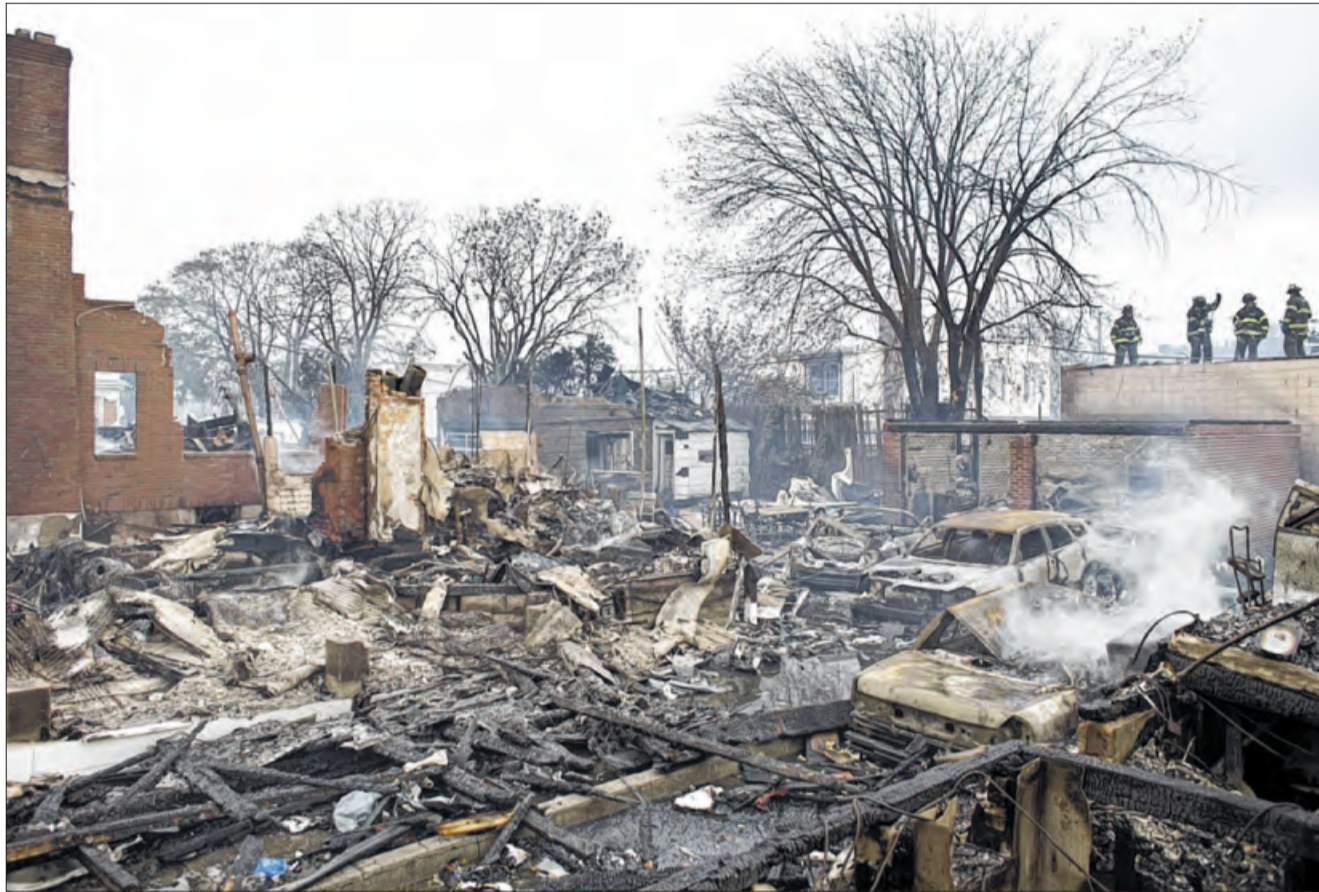
Ein verwüstetes Gebäude in Breezy Point im New Yorker Stadtteil Queens und ein abgeknickter Kran in Manhattan.
